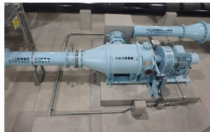
小水力発電設備 (江北給水所)
