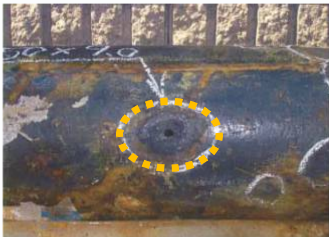
〈孔食の状況写真〉
