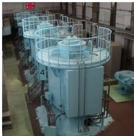
省エネ型ポンプ設備 (上井草給水所)
