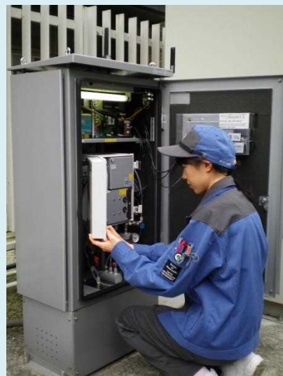
自動水質計器による 残留塩素濃度の常時監視
