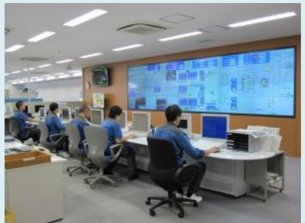
浄水場での運転管理業務の様子
