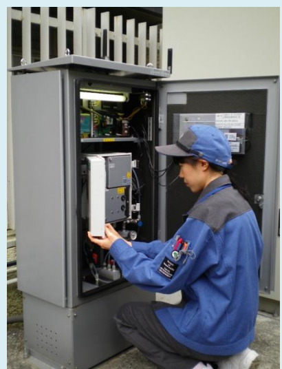
自動水質計器による 残留塩素濃度の常時監視
