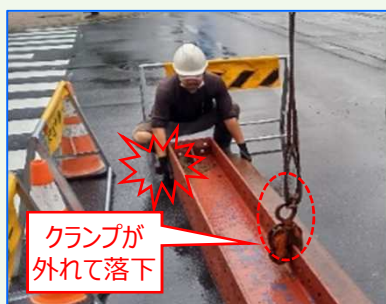
H型鋼材底部を手で掴んでおり被災(R4年度)
