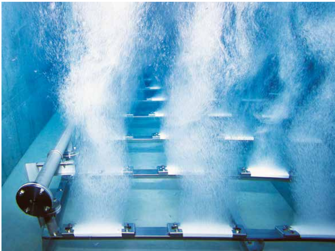
▲ オゾン接触池
