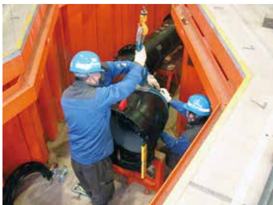
▲ 大口径配管訓実習施設
