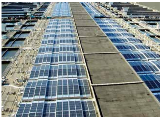
Solar Power Generation (Asaka Purification Plant) 太陽光発電設備（朝霞浄水場）
