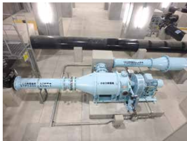
Small Hydraulic Power Generation (Kohoku Water Supply Station) 小水力発電設備（江北給水所）
