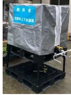
〔京都市の仮設水槽〕
