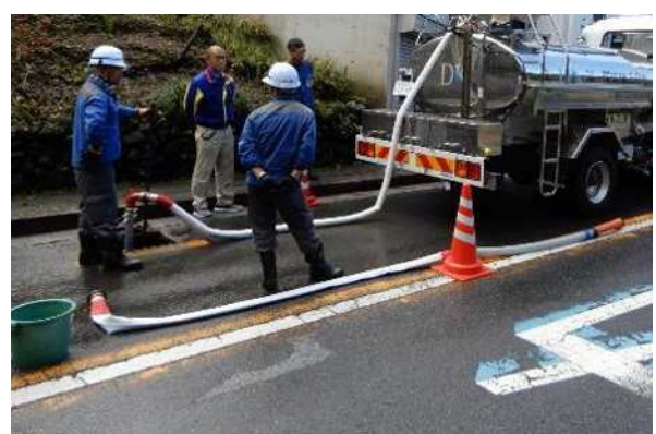
〔消火栓を活用しての注水〕
