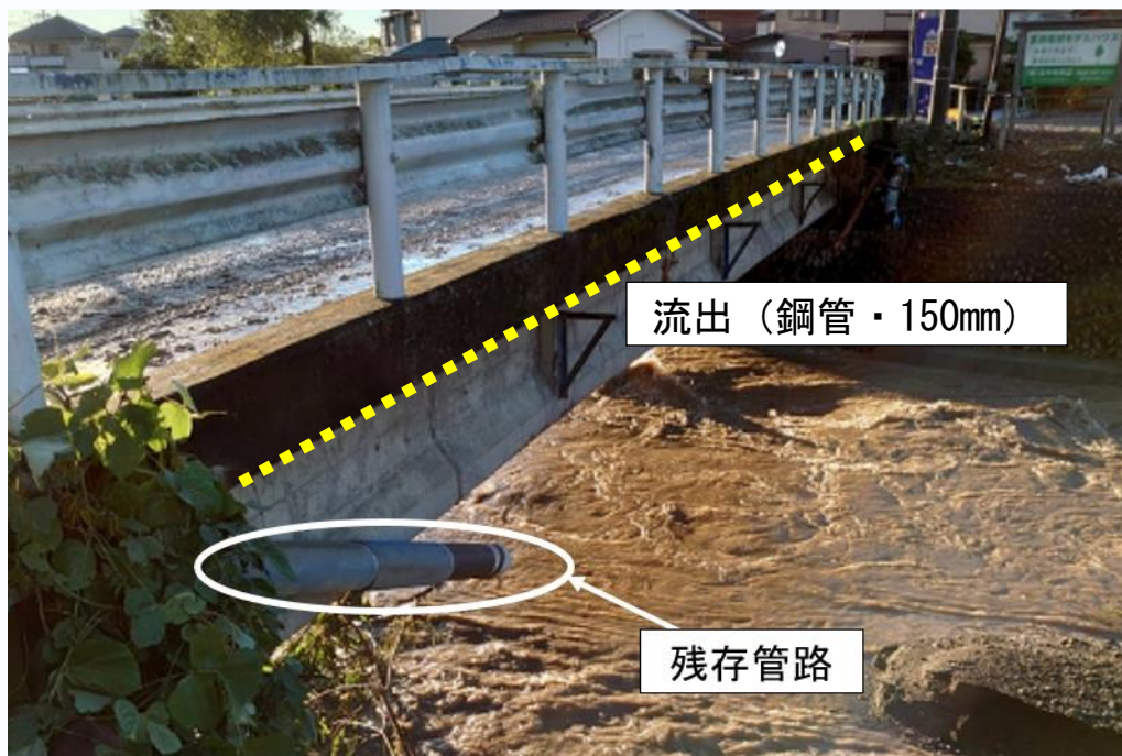
添架管の流出（日の出町：玉の内橋）
