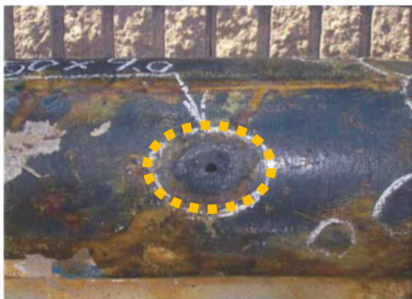
孔食の状況写真
