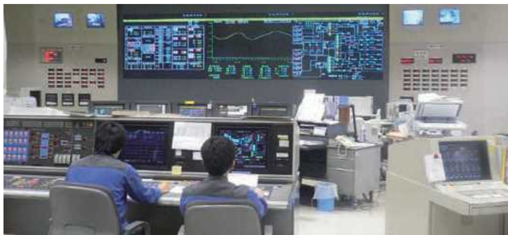
▲浄水場全体をコントロールしている管理室
