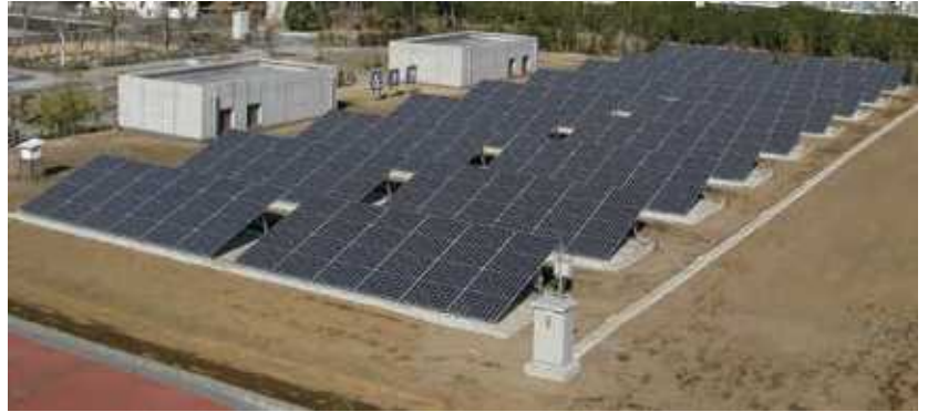
▲配水池の上の太陽電池
