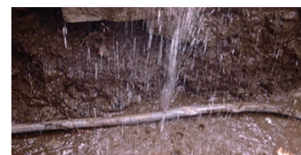
▲水道管からろう水し、水がいきおいよくふき出している様子
