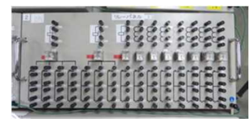
【Fig.9】 Panel example (Relay Panel)
