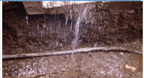
<給水管から漏水している様子>
